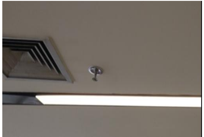
Sistema de chuveiros para extinção de incêndio (sprinkler) Prédio Torre: 227 bicos
