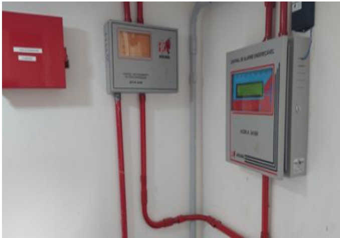
Centrais de detecção e alarme de incêndio: 13 unidades, painel repetidor de detecção, alarme de incêndio: 32 unidades e sistema completo de interligação wireless das centrais de alarme e detecção de incêndio.
