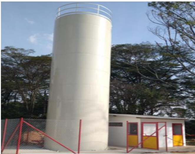
Reservatório metálico tubular com capacidade de 65.000 l para reserva de incêndio e sprinkler do Prédio Torre – ESTACIONAMENTO NA Dr. Dante Pazzanese, 244.
